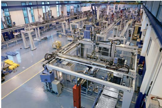
Vista general de componentes de la instalación
